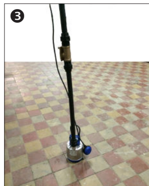
Pumpinredning monterad och klar.
