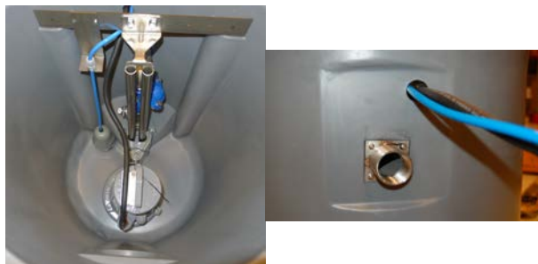
Kablarna från pump och kabel/slang från
